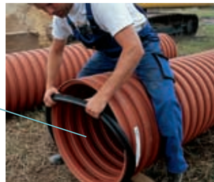
4 Kumitiiviste sovitetaan nousuputken alimmaiseen uraan. Kaivon muotoilun ansiosta on mahdollista täyttää kaivon ja viemäriputken ympäryksy ennen kuin korrugoitu nousuputki asennetaan.
