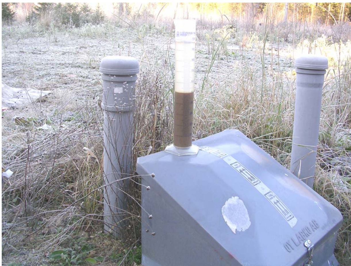
Kuva 1. Kiinteistö 3 (Labko Biokem 6 panospuhdistamo) ja mittalasisissa tehty laskeutuskoe.
